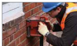
1. Schraap of frees sleuven uit in de lintvoegen, tot minimaal 500 mm aan beide kanten van de scheur
