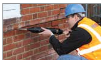
3. Gebruik het Helifix voegpistool om een ril HeliBond langs de achterkant van de sleuf aan te brengen
